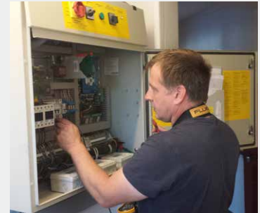
Karsten Porsch (47), Energieanlagen-elektroniker und Dipl.-Ing Elektrotechnik, mehr als 20 Jahre tätig in der Industrie, seit 2015 selbstständig und seit 2016 Sachverständiger bei GTÜ AS für den Bereich Aufzug
